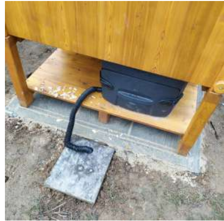
Zugang zur Wartungsklappe der Biolan eco von hinten.
