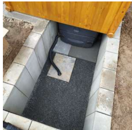
Die Biolan ist in eine Wartungsschach vertieft.
